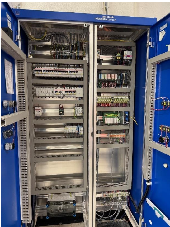
Gesamtersatz hydraulische Ausrüstung
